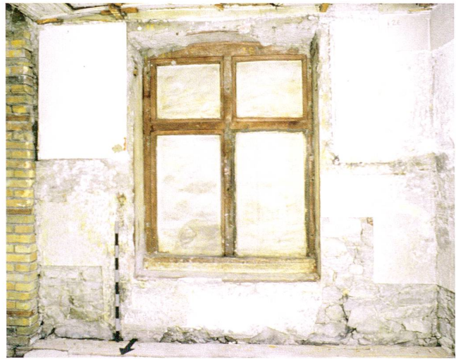
Abb. 60 Zug, Neugasse 31, Wohnhaus. Drittes Obergeschoss, Südfassade. Im 18. Jahrhundert zugemauertes Kreuzstockfenster von 1525. Ansicht von innen.
