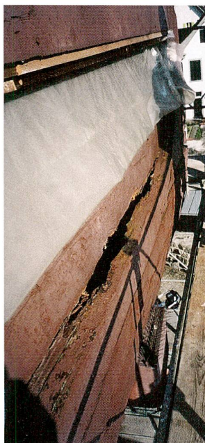
Abb. 47 Zug, Kirchenstrasse 11, Burg. Wasserschaden an der Nordschwelle des 1355 errichteten Bohlenständerbaus.
