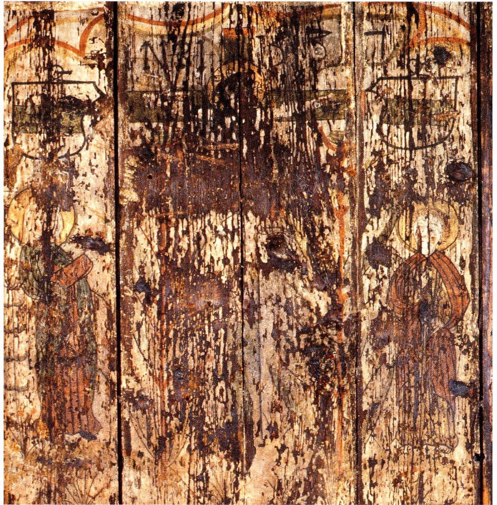
Abb. 3 Zug, Grabenstrasse 8. Erstes Obergeschoss, Westraum, südliche Bohlenwand. Kreuzigungsszene mit Maria und Johannes, 1537 datiert.
