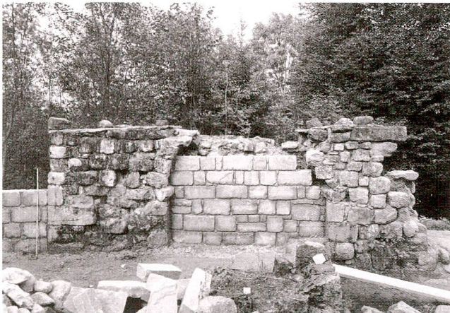
Abb. 8 Burgruine Hünenberg, Torbau, Blick Richtung Nordosten. Als man 1961 mit der Sanierung begann, konnte von reinen Sicherungsarbeiten bereits nicht mehr die Rede sein. Die meisten Mauern mussten mit einem neuen Mauermantel, einzelne Mauerabschnitte sogar mit einem neuen Mauerkerne versehen werden.
