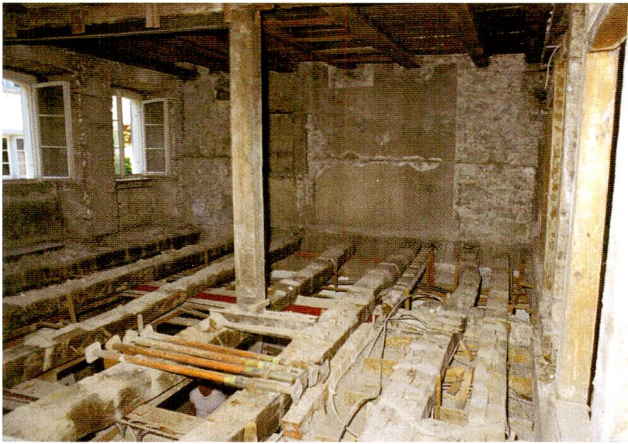
Abb. 51 Zug, Zeughausgasse 21. Die Balkenlage über dem Erdgeschoss stammte noch von 1526 und bestand sowohl aus Nadelhölzern wie auch aus Eichen. Übersicht nach Norden.
