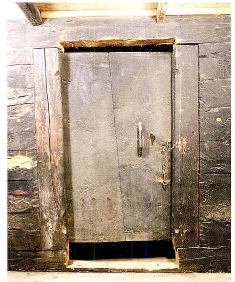
Abb. 15 Walchwil, Lauihof. Aussenseite der Türe in die Kammer über dem Südteil der Küche (Raum 16) im Obergeschoss. Das Türblatt dürfte aus der Bauzeit stammen. Blick nach Nordosten.
