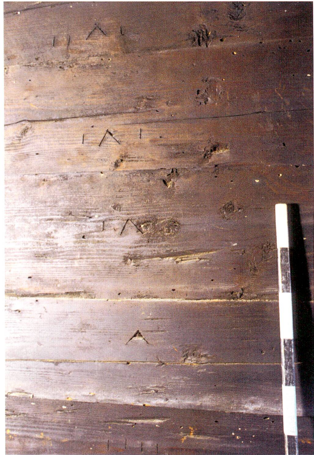
Abb. 17 Walchwil, Lauihof. Nummerierungszeichen an der Nordwestwand der obersten Dachkammer. Die Wand stammte von der ursprünglich tiefer gelegenen Kammer des alten Daches, wurde aber beim Umbau des Dachgeschosses als Ganzes versetzt und daher nummeriert. Blick nach Südosten.
