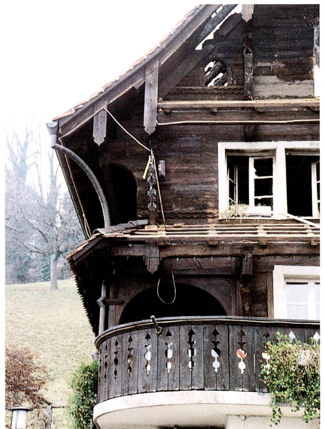
Abb. 37 Walchwil, Zugerstrasse 80, Restaurant Hörndli. Lauben, Vordächer und Zierformen an der seeseitigen Fassade, nach dem Brand. Blick Richtung Osten.
