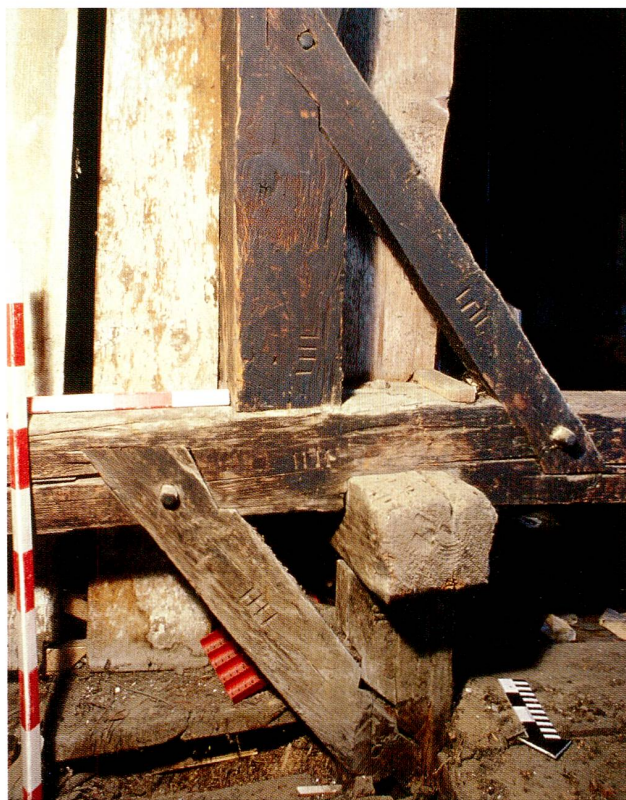
Abb. 23 Baar, Rathausstrasse 6/8. Dachgeschoss, viertes Stuhlloch. Übergang der Stockwerkkonstruktion des zweiten Obergeschosses zur Dachkonstruktion mit Abbundzeichen «III». Blick Richtung Süden.
