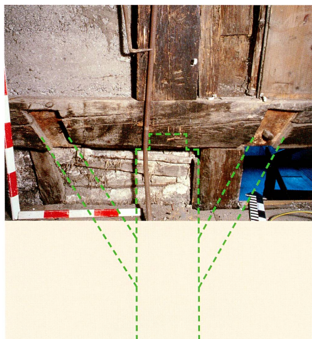
Abb. 24 Baar, Rathausstrasse 6/8. Dachgeschoss, drittes Stuhlloch. Übergang der Stockwerkkonstruktion des zweiten Obergeschosses zur Dachkonstruktion mit Blattsassen von Kopfstreben, die zu einem senkrecht darunter stehenden, nicht erhaltenen Ständer (359) gehörten. Die Lage des ehemaligen Ständers ist grün gezeichnet. Blick Richtung Norden.
