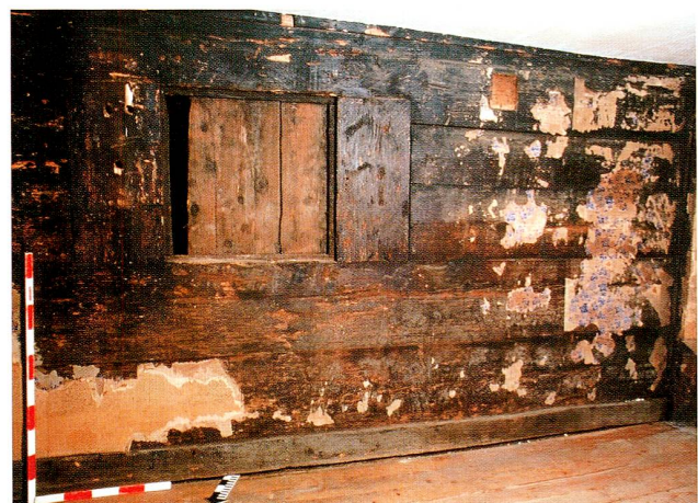
Abb. 15 Baar, Rathausstrasse 6/8. Raum 11. Südwand (18) von innen mit originalem Fenster (84). Gut sichtbar ist der 3 cm breite Falz, der als Anschlag für den Fensterrahmen diente. Das Fenster wurde in Phase 3 wieder zugesetzt. Die Wandkonstruktion besteht in diesem Raum aus exakt bearbeiteten, breiten Bohlen, die ohne Verschmälierung in die seitlichen Ständernuten eingelassen waren.
