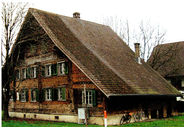
Abb. 12 Cham, Ochsenlon. Westfassade und südliche Traufseite nach der Abnahme von Verkleidungen. Ende 2001.
