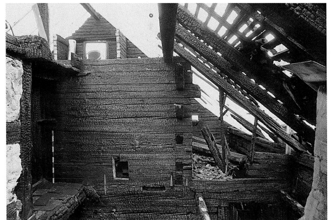
Abb. 23 Zug, Oberwil, Artherstrasse 111/113. Dachgeschoss mit Resten des Kernbaues in Blockbauweise. Blick Richtung Südwesten.
