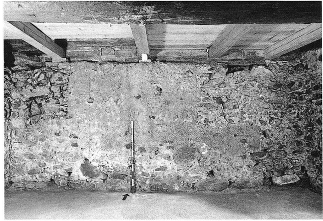
Abb. 16 Menzingen, Halthof. Keller. Eine deutliche Grenze trennt das ältere, untere Mauerwerk vom jüngeren, oberen.
