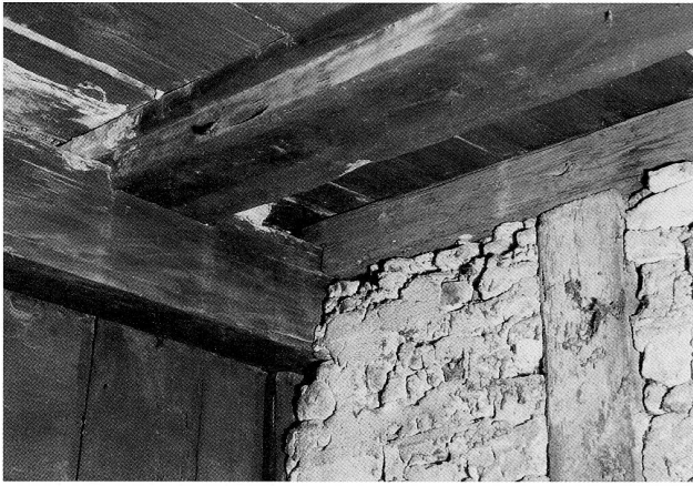
Abb. 27 Zug, Oberaltstadt 17. Zweites Obergeschoss, Nordwest-Ecke. Links die durchlaufende alte Bausubstanz, rechts die später eingezogene Fachwerkwand.
