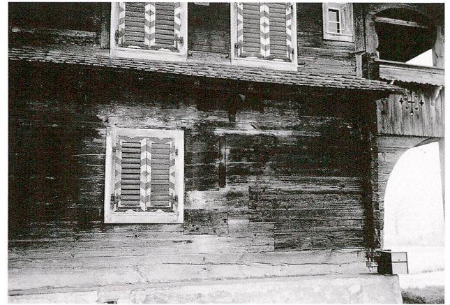
Abb. 5 Zweieren, Haus A. Nördliche Giebelseite, westlicher Teil. Im Erdgeschoss ist ein Pfosten der ursprünglichen Befensterung erhalten, auch der Zahnfries im Obergeschoss gehört zum ältesten Bau. Das Klebdach wurde nachträglich an der Stelle eines Vorgängers errichtet. Im Erdgeschoss ist rechts ein grosser Flick zu erkennen. Darunter, im Kellersockel, befindet sich eine zugemauerte Tür (nur von innen her zu sehen).
