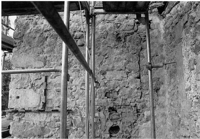
Abb. 7 Aussenseite der Nordwand des Kapitelsaales im Ostrakt (zur Lage vgl. Abb. 2). Die romanische Bausubstanz reicht vom Turmunterbau (auf dem Foto rechts) bis in die Nordwand des Kapitelsaales (links). Deutlich ist in der rechten Bildmitte die vertikale Baufuge zu erkennen.
