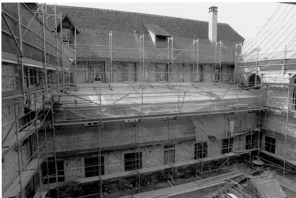
Abb. 17 Innenseite des westlichen Kreuzgangflügels. Im Obergeschoss zeichnen sich die Partien in Fachwerk und Ständerbauweise ab, die dendrochronologisch auf um 1620, 1479 bzw. 1531 und 1580 datiert werden. Rechts ist die Südseite der Klosterkirche zu sehen.
