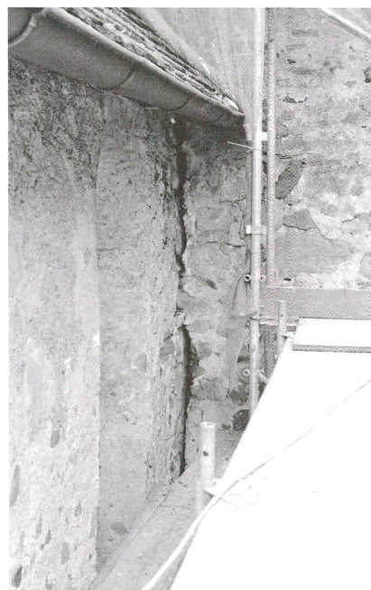
Abb. 12 Cham, Kapelle St. Andreas. Riss zwischen dem Kapellenturm (rechts) und Kapellenschiff.
