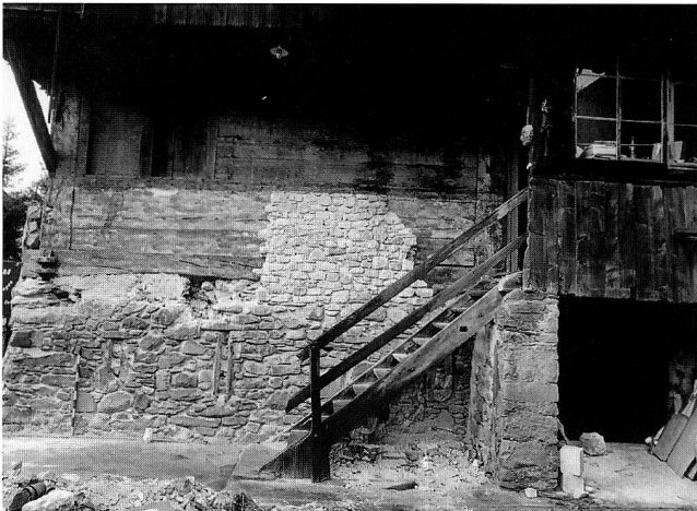
Abb. 34 Zug, Aabachstrasse 10, Grafenau. Blick Richtung Westen auf den Südteil der Ostfassade, nach Freilegungsarbeiten 1995. Hinter jüngerm Mauerwerk wird der ursprüngliche Substruktionssockel mit mehreren Schlitzfenstern sichtbar. Darauf sitzt der Ständerbau, dendrodatiert auf (frühestens) Frühjahr 1457.
