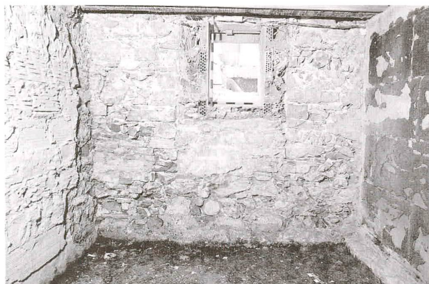
Abb. 28 Zug, Grabenstrasse 3. Erdgeschoss, Kühlraum im Südosten. Blick Richtung Süden auf die Innenseite der Südwand, vor Erstellung der Sondierlöcher. Deutlich sind die Befundgrenzen im Mauerwerk erkennbar, die anzeigen, dass aus der ursprünglichen Tür in zwei Schritten ein Fenster gemacht worden ist.
