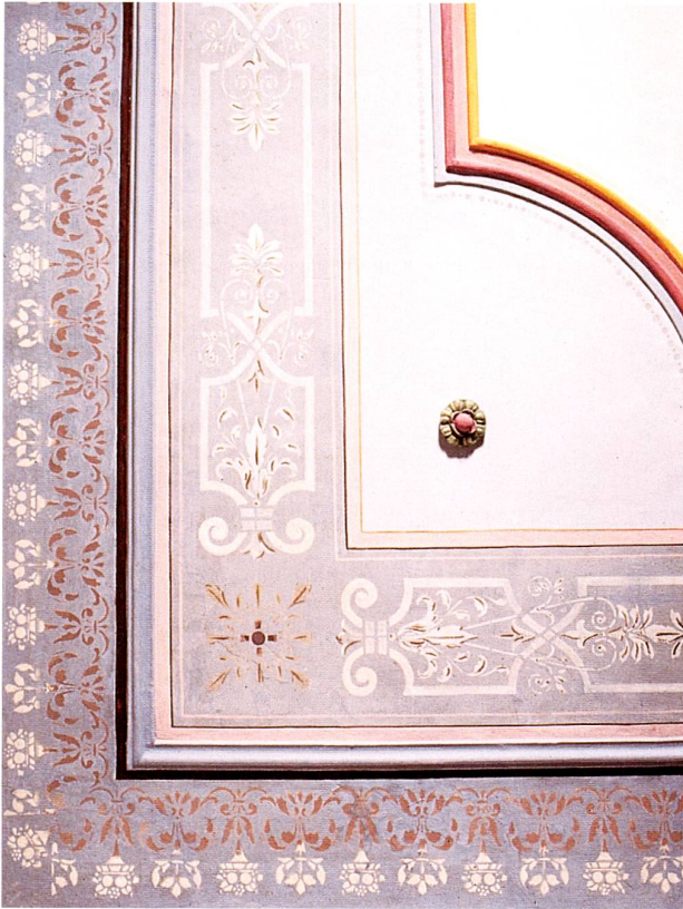
Abb. 5 Zug, Löberenstrasse 7. Detail der Deckenbemalung von 1897 in der Küche, nach der Restaurierung 1994.
