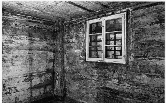
Abb. 18 Cham, Haus Obermühle, Erdgeschoss, Nordwest-Raum. Perspektive ähnlich der vorhergehenden Abbildung, nach Freilegungsarbeiten 1990. Erkennbar werden die alten Fensterpfosten seitlich neben dem aktuellen Fenster, das den Standort beibehalten hat.
