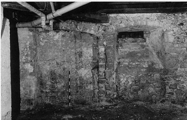
Abb. 14 Cham, Haus Obermühle, Untergeschoss. Blick auf den östlichen Teil der Innenseite der Nordmauer. Links ein vermauertes grosses Tor, rechts der Rest eines Fensters bzw. einer Tür.
