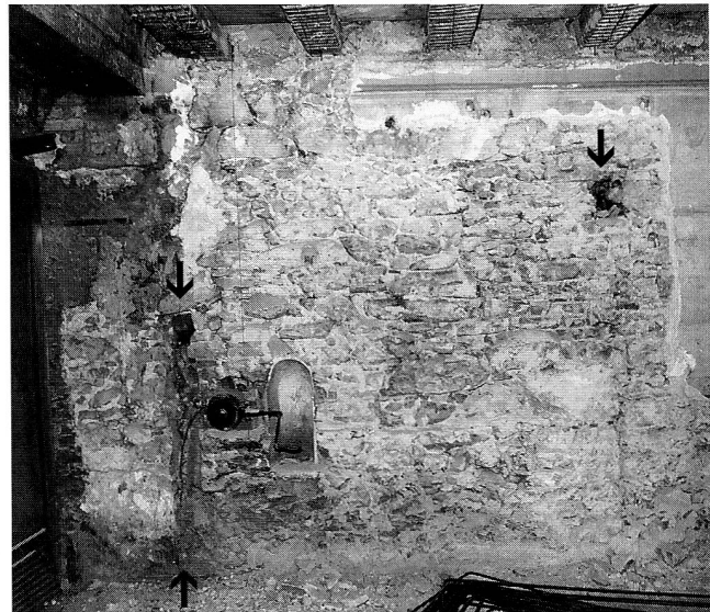
Abb. 5 Stadt Zug, Ägeristrasse 9, Erdgeschoss. Blick Richtung Westen auf die Südhälfte der Westwand (= Trennwand zu Haus 7); aufgenommen 1989. Unter dem abgelösten modernen Verputz fanden sich ein Balkenkopf-Negativ (Pfeil rechts) sowie die Reste eines eingemauerten Bälkchens (Pfeile links).
