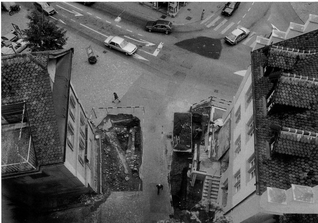
Abb. 2 Zug, Kolinplatz. Leitungsgräben vor dem Zyturm. Freigelegte Mauerreste der alten Brücke über dem Stadtgraben, 13. September 1985 (vgl. Objekt Nr. 195).
