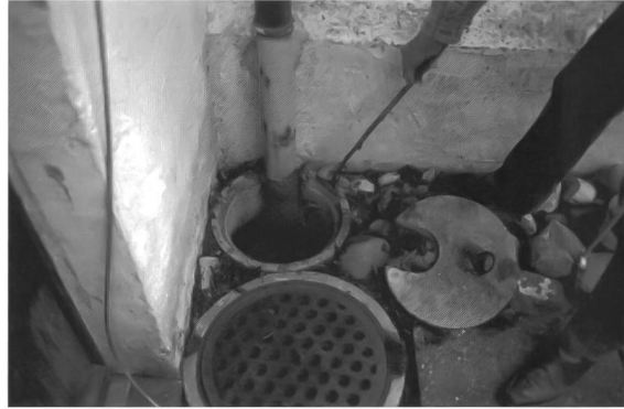
Schäden durch mangelhafte Sockelentwässerung, Zell, Reformierte Kirche
