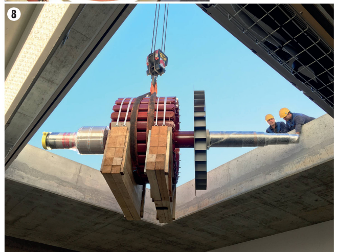
Il rotore del generatore. (foto 8)
