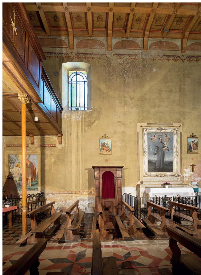
Intonaco deteriorato, da risanare (Foto Massimo Pedrazzini)
