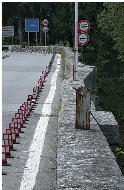
L'evidente degrado del vecchio parapetto.
