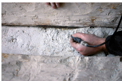
6- Completa demolizione della malta mediante microablatori: le travi della soletta sono distanziate tra loro a cm 20 e sono svasate per accogliere il riempimento in assi posizionati a coltello. Sotto il legno, per migliorare l'ancoraggio della malta, è presente una ramificazione di chiodi e filo di ferro.
