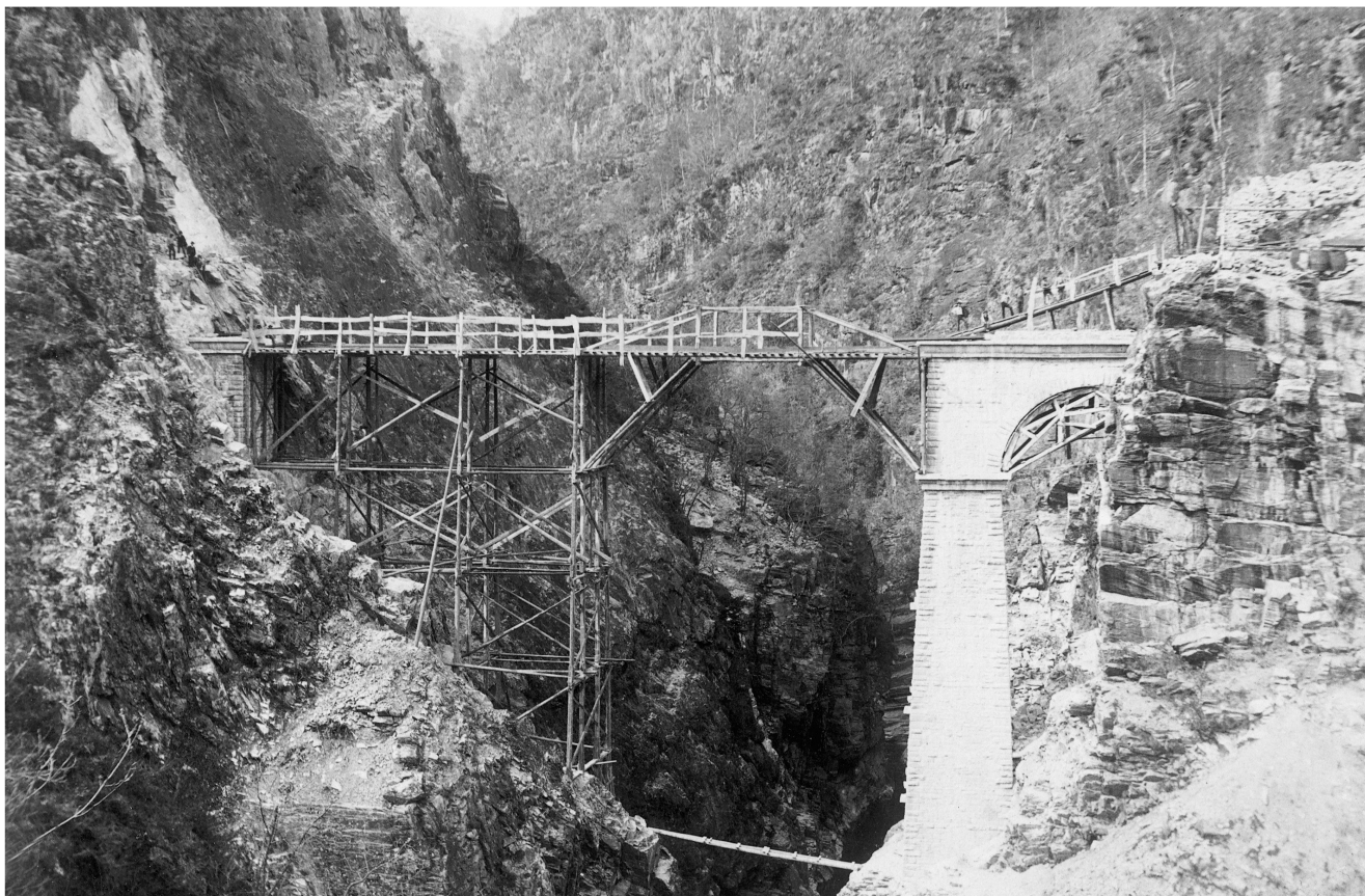
La costruzione del ponte in ferro della Gura (foto Angelo Monotti - archivio Museo regionale)
