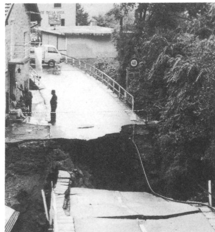
Il ponte di Cavigliano, così come si presenta dopo il nubifragio del settembre scorso
