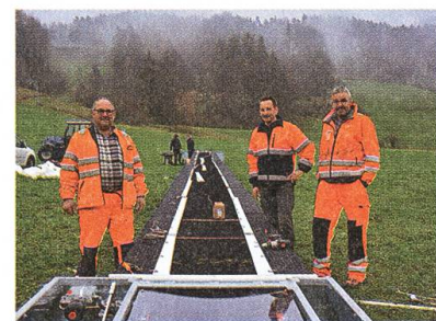
Montage des Zauberteppichs beim Skilift Gähwil.
