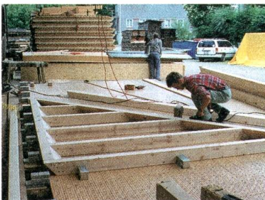
Auch die Fertigung eines montagebereiten Dachelementes bei Scherrer in Bütschwil darf als Präzisionsarbeit bezeichnet werden. Slg. Scherrer Holzbau.
