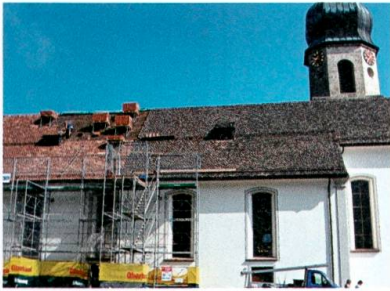
Kirchendach hat Sanierung nötig.
