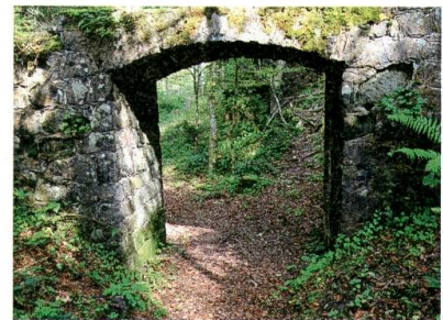
Der Starkenbacher Sandstein hielt. Der Torbogen des Westausgangs im Juli 2013.
