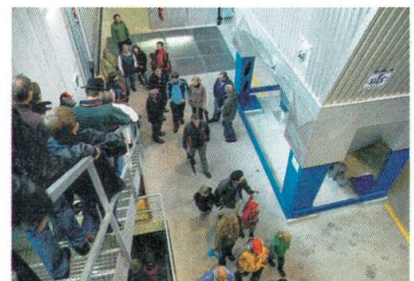
Tag der offenen Türe in der Heizzentrale.
