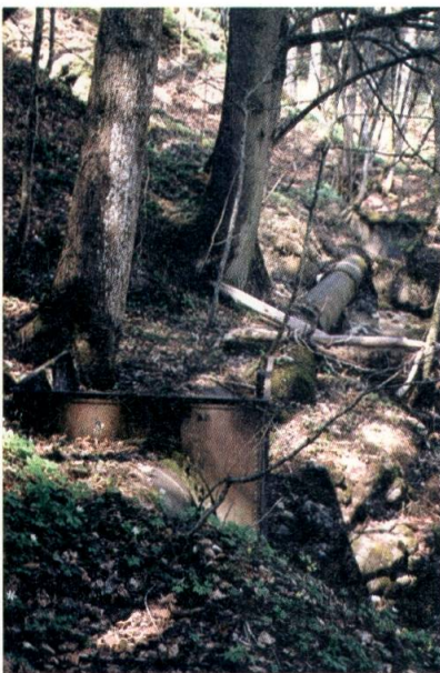
Rohrleitung mit Überlaufkasten.
