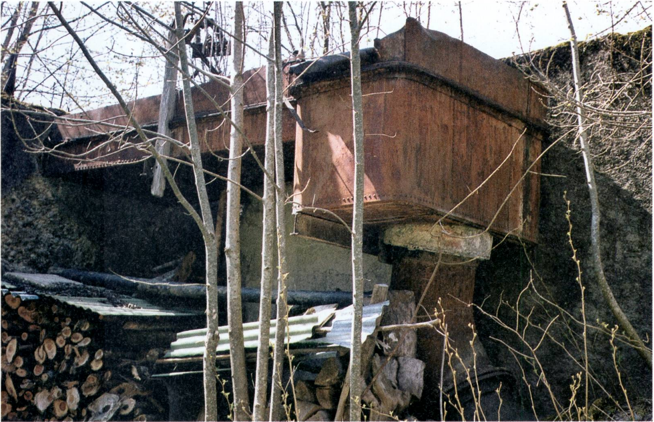
Einlaufkasten am Turbinenhaus.
