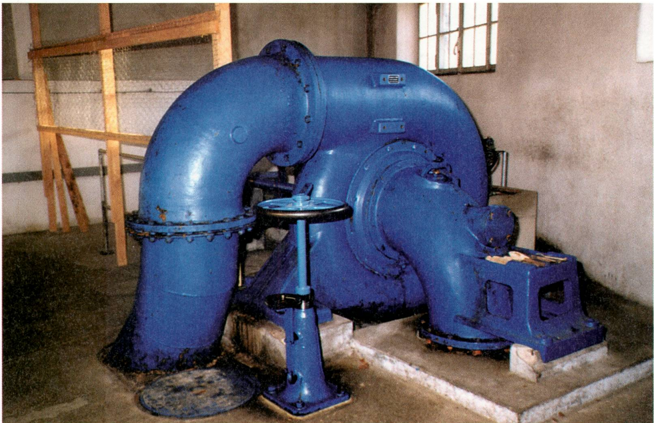
Absperrschieber an der Oberwasser-Einleitung.
