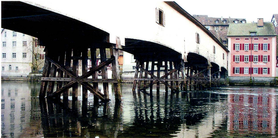
In den Jahren 1814–16 wurde die heutige, gedeckte Holzbrücke, die als Baudenkmal unter Bundesschutz steht, erbaut.
