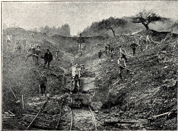
Die Rutschstrecke im Lengwiler Einschnitt.
