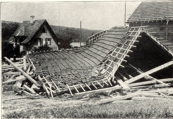
Ein Neubau am Untersee, der durch den Sturm einstürzte.
