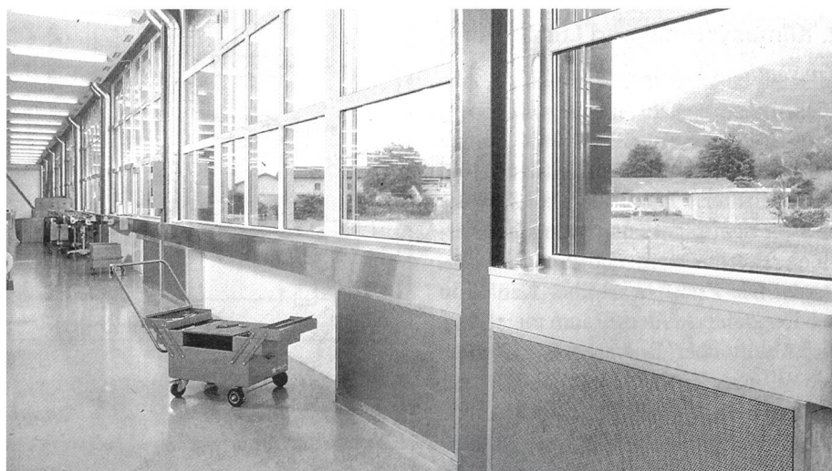
Liptex-Klimaanlage bei Schoeller Switzerland
