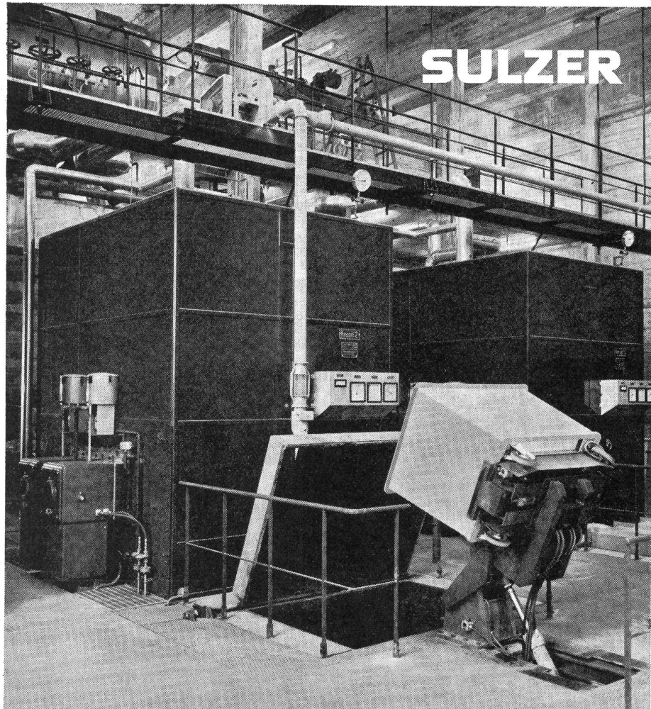
Heizzentrale eines Versand- und Lagerhauses mit 2 Heißwasserröhrenkesseln von je 2,5 Mio kcal/h mit hydraulischer Kippvorrichtung für das Verbrennen verschiedenster Abfälle.
