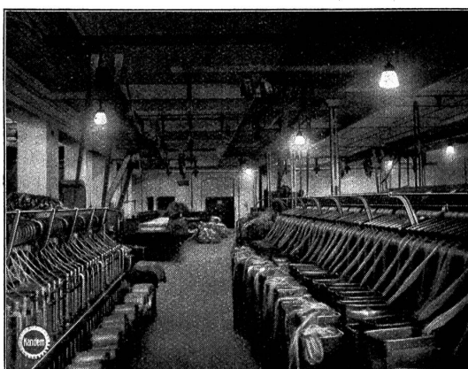
Abb. 5. Vorbildliche Beleuchtung durch staubdichte Kadem-Leuchten für vorwiegend tiefstrahlendes Licht.
