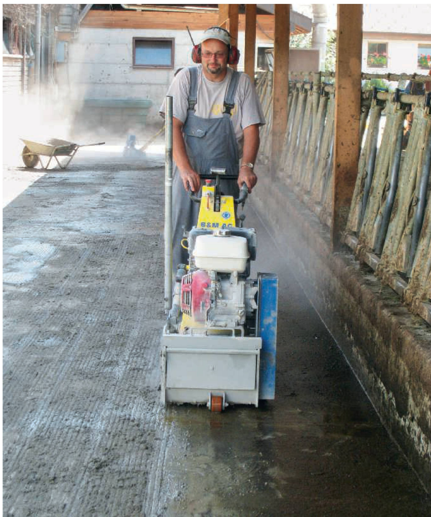
Les procédés d'assainissement mécaniques doivent être adaptés aux exigences des animaux et à celles de la technique. Photos : B+M, Densbüren, Agroscope et Beat Steiner
