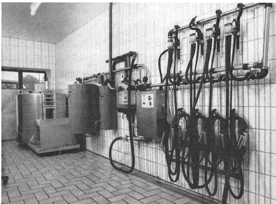
Salle à lait avec installation moderne, à savoir: le récipient-écluse, le nettoyeur automatique, des dispositifs de suspension pour les pots trayeurs, un lavabo et une armoire pour ranger des instruments et des produits détergents.
