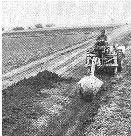
Fig. 3: Après avoir bien mélangé la terre, le liant et l'eau, il faut creuser les fossés latéraux du futur chemin d'exploitation à l'aide de la grue hydraulique portée munie d'un godet rétrocaveur. Le godet creuse la tranchée, évacue la terre et la décharge à peu de distance par mouvements successifs rapides.
