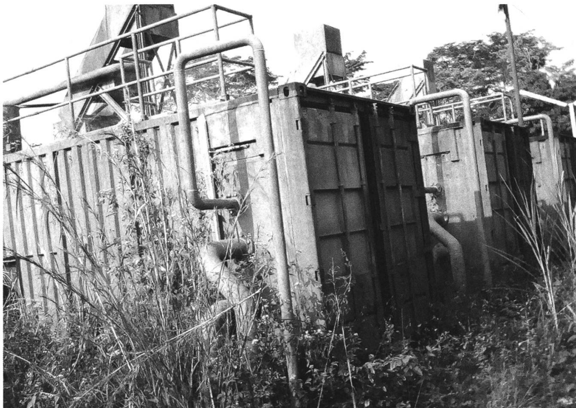
Figure 1: Vue externe de la station de traitement des eaux de NdiKiniméki, financée par le crédit mixte bilatéral I, photographie de l'auteur, 11 décembre 2019.
