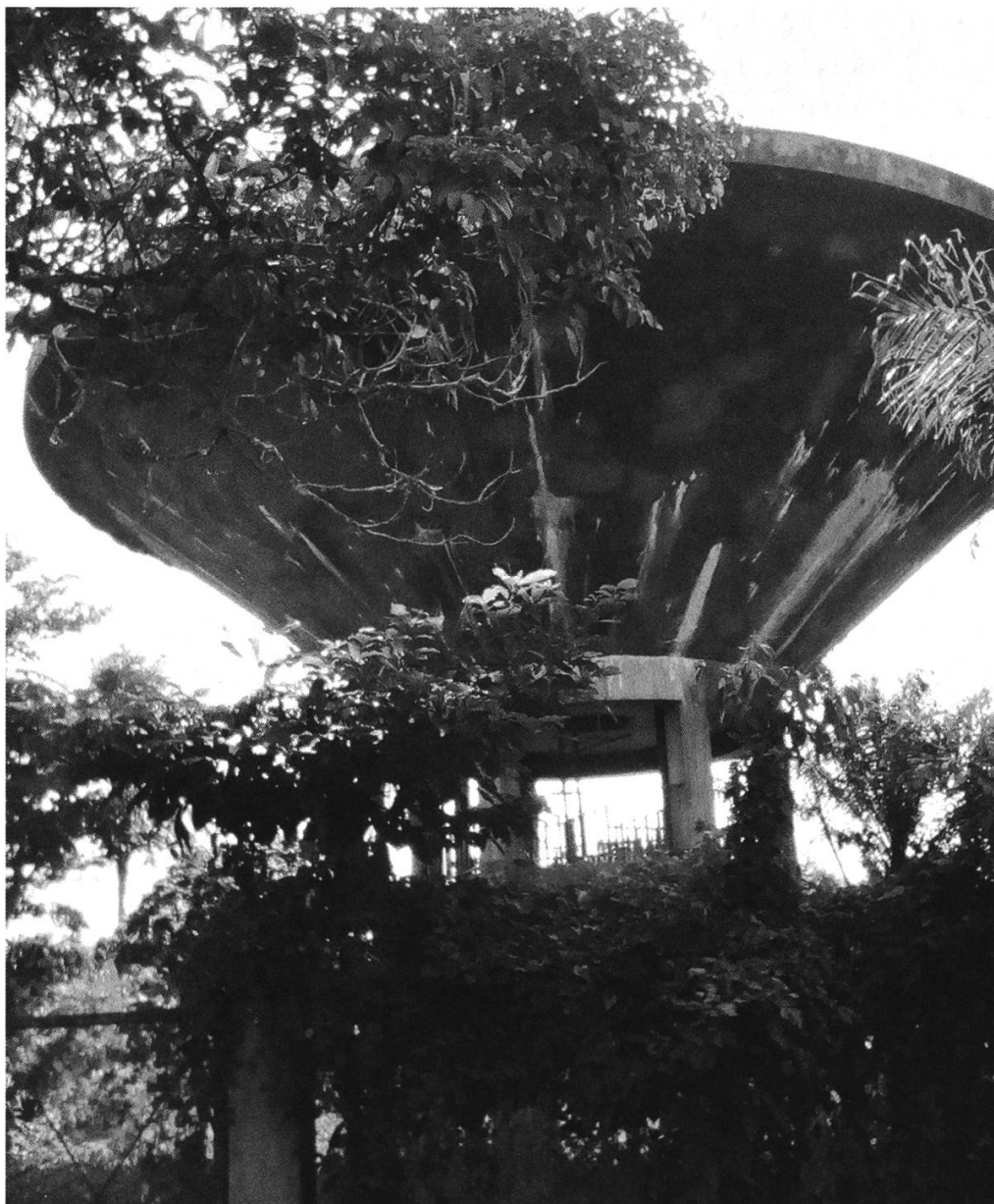
Figure 5: Château d'eau de Makénéne, vue de la partie supérieure, photographie de l'auteur, 11 décembre 2019.
