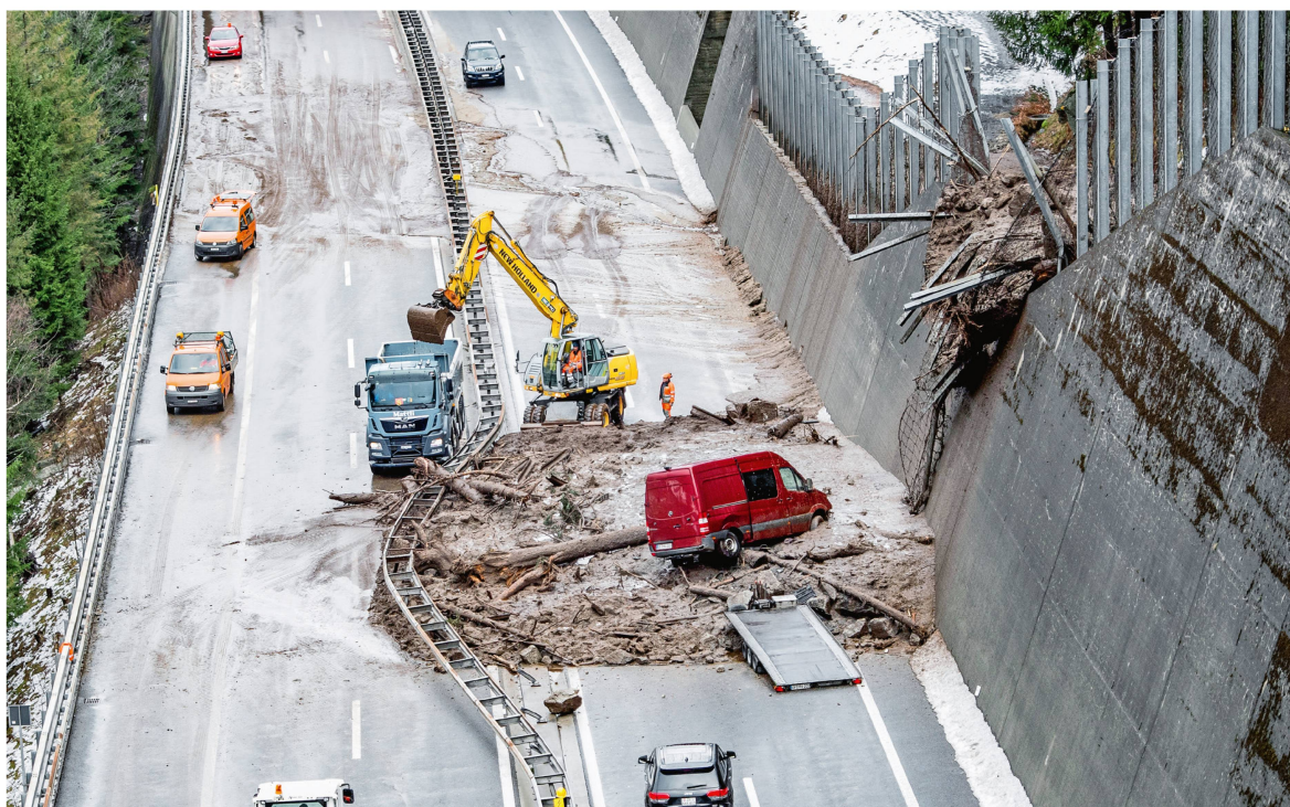
Abb 1 Eine Hangmure von rund 400 m 3 verschüttete am 23. Januar 2018 die Gotthardautobahn A2 zwischen der Wilerplanggen und der Ripplistal-Galerie über eine Breite von 50 m. Foto: Urs Flüeler / Keystone SDA
