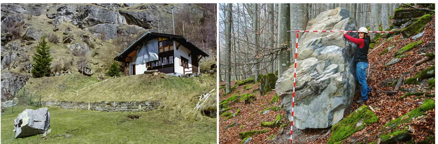
Abb 1 In der Unwetterschaden-Datenbank der Eidgenössischen Forschungsanstalt WSL werden auch Sturzereignisse berücksichtigt, sofern sie in den Medien Erwähnung finden. Der 2 m 3 grosse Felsblock, der im Jahr 2003 ein Haus in Evolène VS durchschlug (links), ist erfasst; der 5 m 3 grosse Block, der bei Matt GL von einer Buche im Wald gestoppt wurde (rechts), hingegen nicht.
