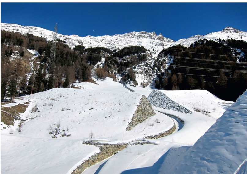
Abb 2 Auffangdämme als Anpassung an den auftauenden Permafrost in Pontresina.
