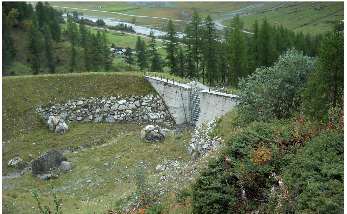
Abb 4 Rückhaltebauwerk als Beispiel einer Massnahme zur Risikoverminderung. Durch Massentrückhalt werden Reichweite, Dichte und Abflusstiefe reduziert.
