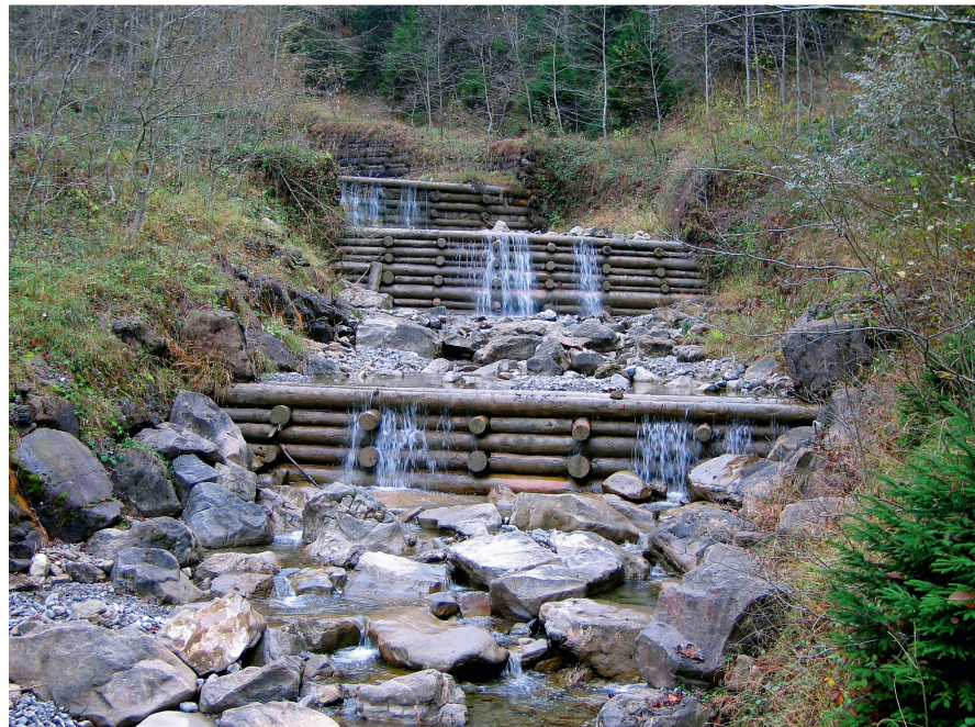
Abb 5 Holzsperrn sind eine andere Variante im Wildbachverbau. Foto: Christian Rickli
