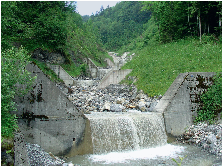
Abb 1 Schutz kann auf unterschiedliche Weise angeboten werden. Im Bild eine Wildbachverbauung mit Betonsperren. Foto: Dieter Rickenmann
