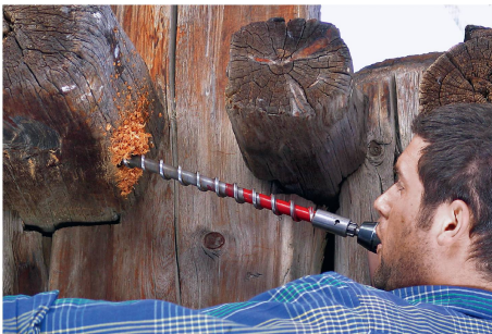
Mit einem Spezialbohrer wird eine Holzprobe aus einem historischen Gebäude im Lötschental (Wallis) entnommen. Foto: WSL
