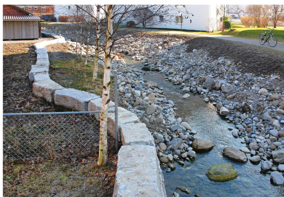
Abb 9 Objektschutz aus Quadersteinen am Dorfbach in Kriens: Durch das Zurückversetzen der Mauer konnte das Fällen der Birken verhindert werden.
