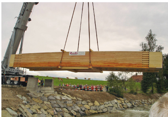
Abb 6 Holz statt Stahl oder Beton: Versetzen einer 40-Tonnen-Holzstrassenbrücke über die Wigger, Egolzwil. Foto: Lawa
